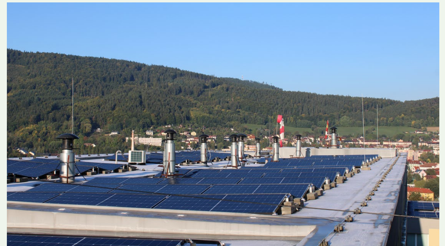
FVE na střechách nemocnice
