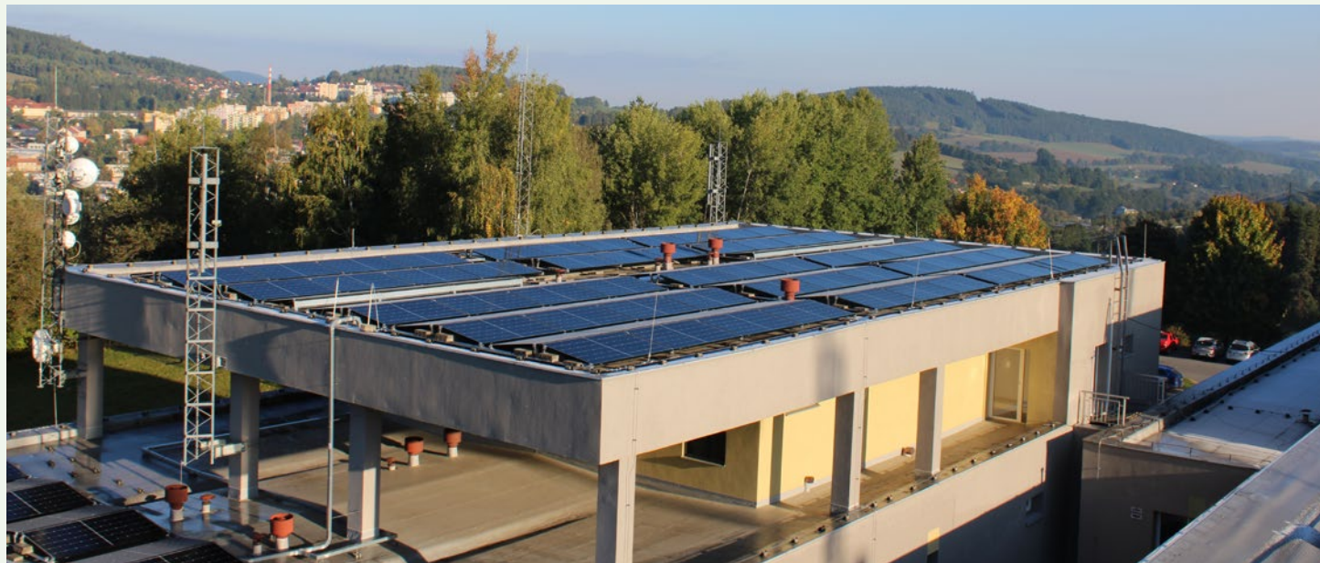
FVE na střeších nemocnice
