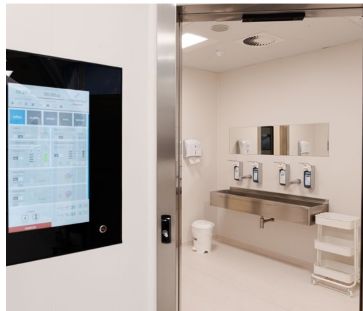
Ovládací panel technologií na operačním sále, umývárna
